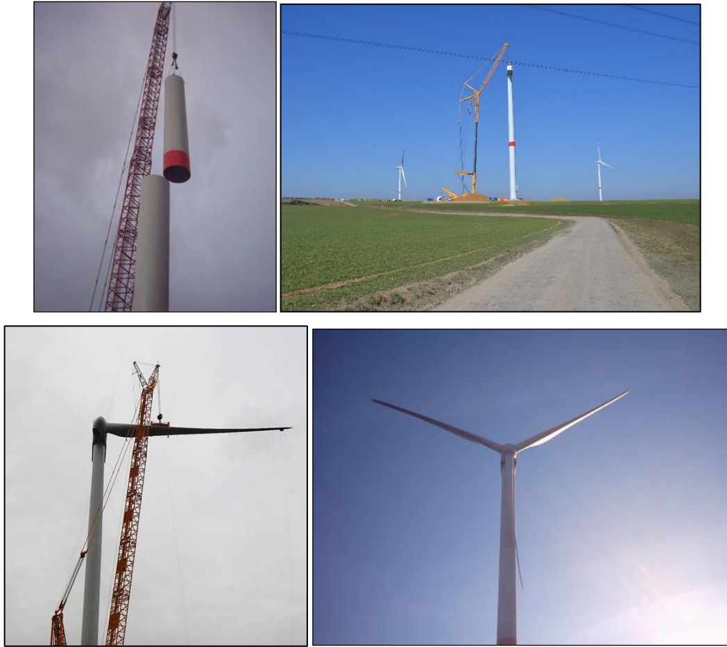
Figure 20 : Différentes étapes du montage d'une éolienne (source : Luminus, parcs éoliens de Villers-le-Bouillet, Ciney et Héron).
