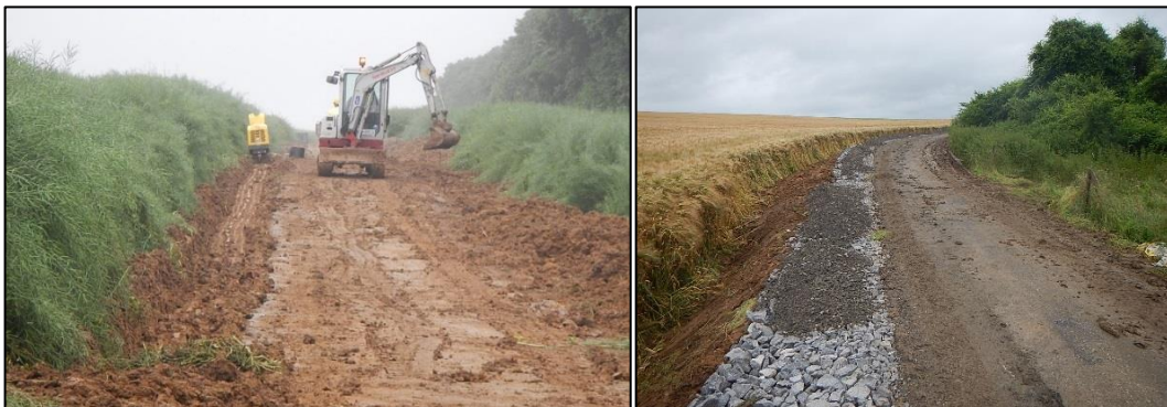
Figure 16 : Décapage du sol en vue de la création d'un nouveau chemin d'accès avec stockage des terres arables en merlons (photos : Luminus, parc éolien de Héron, 2016).
